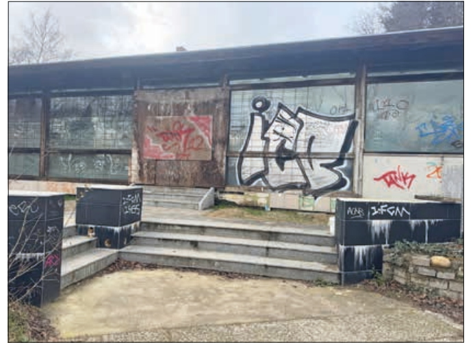
Das Gebäude verfällt immer mehr. Fenster sind eingeschlagen und verbrettert und Wände und Glas mit Graffiti beschmiert. Fotos (2): fle
