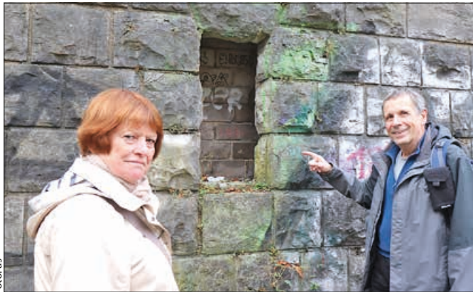
Bruni Wildenhein-Lauterbach und Uli Dalibor weisen auf Schäden hin.
