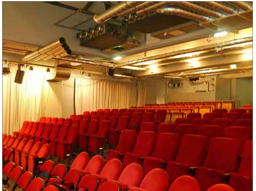
Gute Luft dank neuer Belüftung im Prime Time Theater
