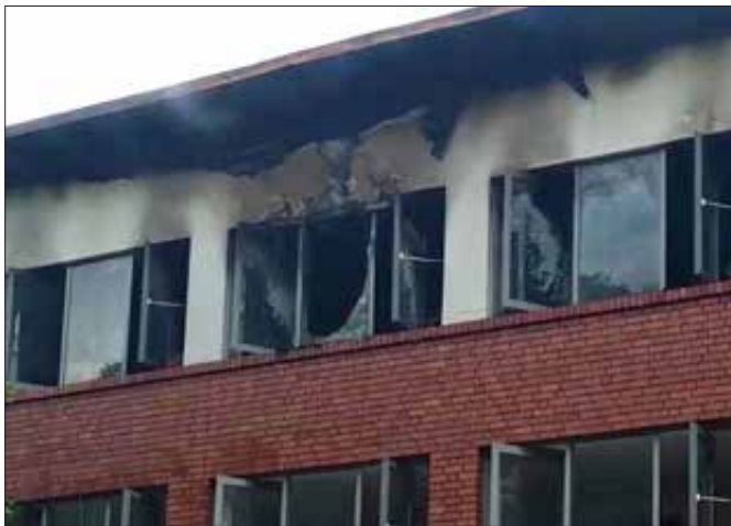
Das Gebäude an der Glienicker Spitze ist jetzt unbewohnbar. Foto: kbm
