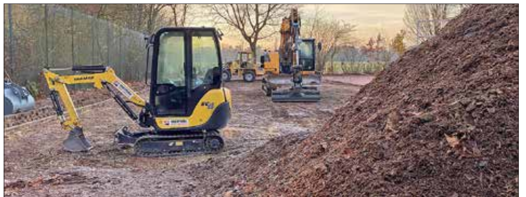
Die Bagger sind schon da, seit dem 23. November wird an der Otfried-Preußler-Schule gewerkelt. Foto: OPS
