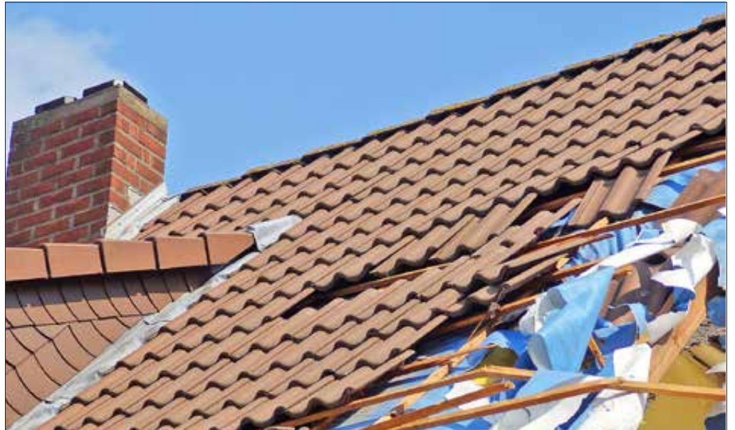
Als „Sabine“ übers Land zog, flog so mancher Ziegel vom Dach.
